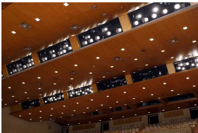
シーリング投光室（客席天井部）
