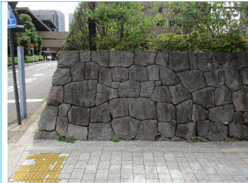
83 石積擁壁B面
