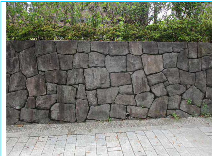
83 石積擁壁B面
