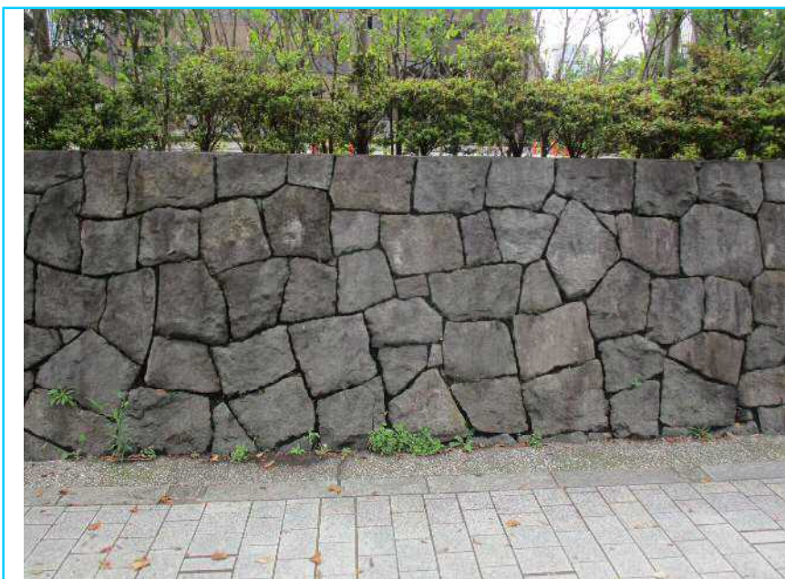
83 石積擁壁B面
