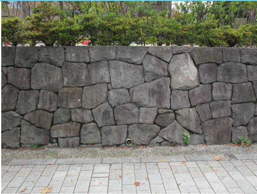
83 石積擁壁B面
