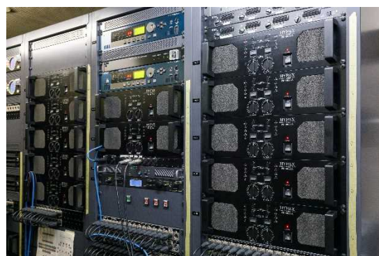
増幅器 (パワーアンプ)
